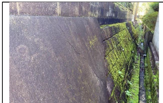
写真6 東側の側部 擁壁に微小な亀裂
