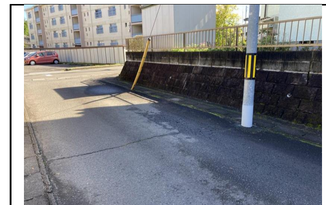
写真16 西側の側部 擁壁から道路にかけて亀裂
