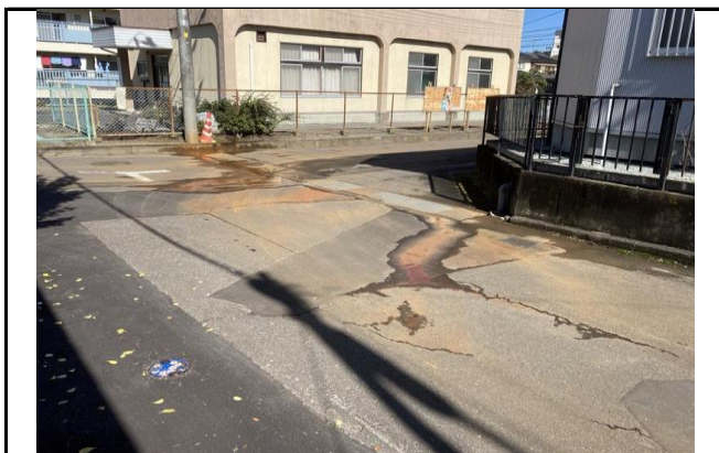
写真5 造成地中央の道路亀裂から湧水
