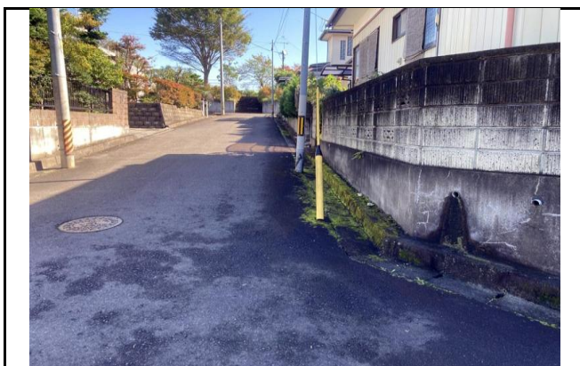
写真13 造成地中央 宅地水抜きから湧水
