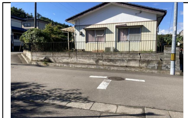
写真10 造成地中央 宅地壁に亀裂
