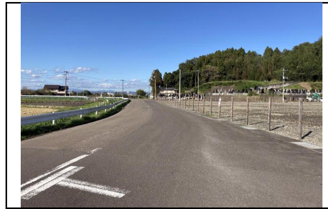
写真14 北側の末端 道路に変状なし
