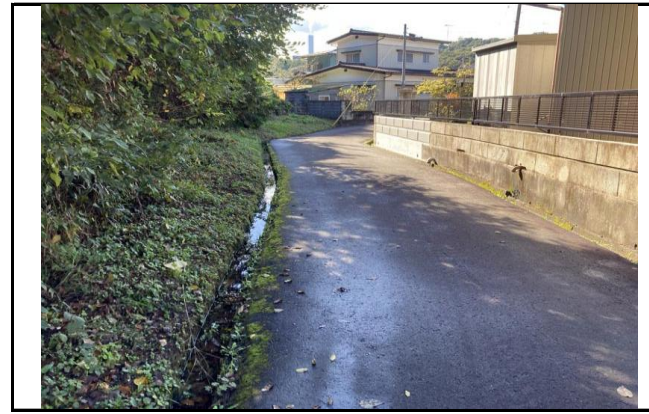
写真6 中央旧谷の頭部付近 側溝に滞水
