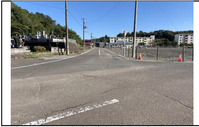
写真1 北側の末端 道路に軽微な亀裂
