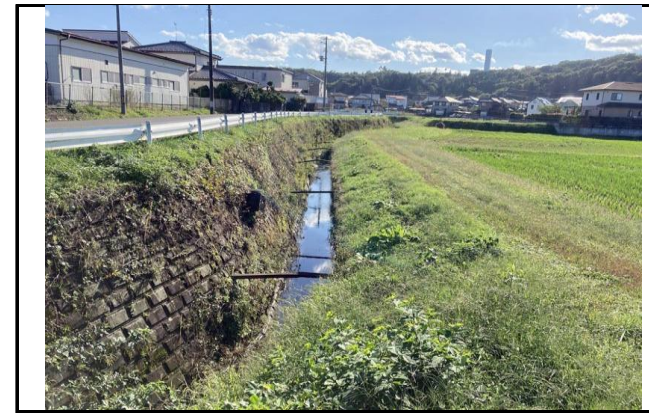
写真15 南側末端 落下した切梁あり、擁壁は変状なし
