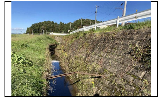
写真16 北側末端 変形した切梁あり、擁壁は変状なし
